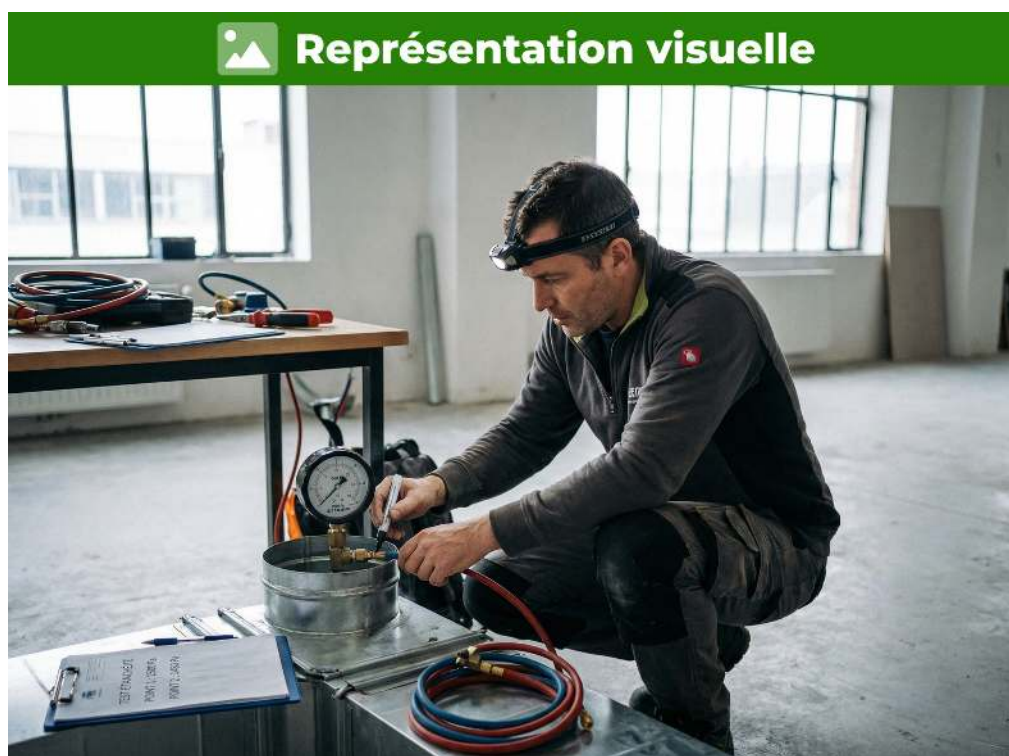
Effectuer un test d'étanchéité à 1,5 fois la pression de service pendant 30 min
